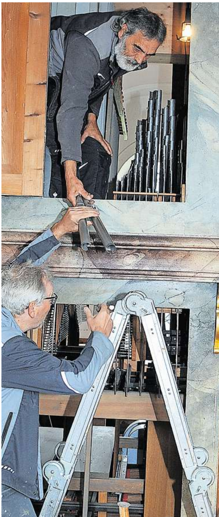
Orgelbauer Helmut Kilger aus Offenberg begann am Montag mit seinem Mitarbeiter die Sanierung der Weißenregener Kirchenorgel. Fotos: Dachs
